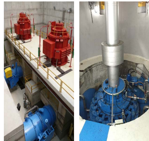
Casa de máquinas Pedregalito 2
