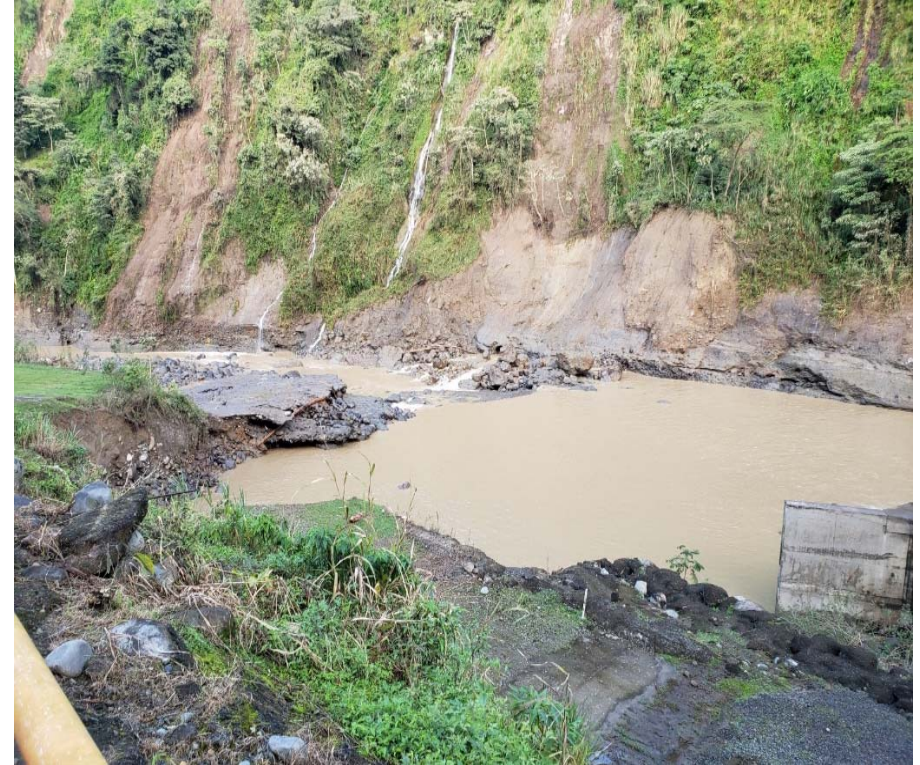
Daños al colchón disipador aguas abajo de la presa
