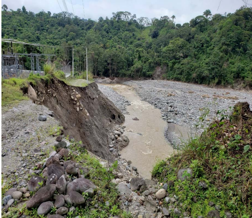
Pérdida de carretera posterior a Subestación Paredones
