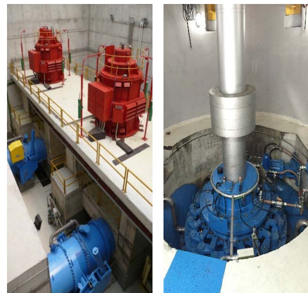
Casa de máquinas Pedregalito 2
