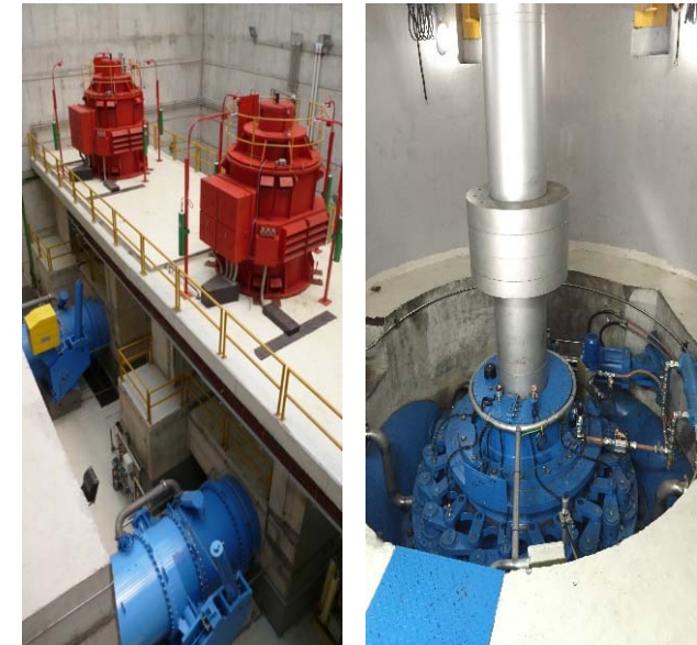
Casa de máquinas Pedregalito 2
