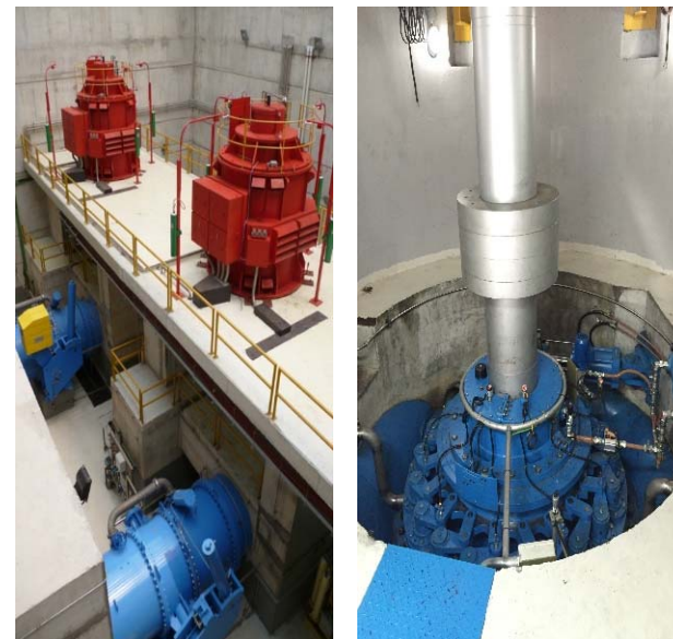
Casa de máquinas Pedregalito 2
