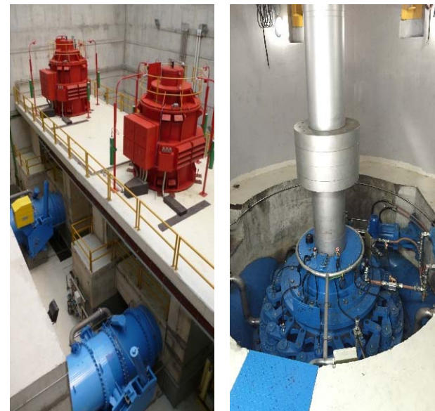
Casa de máquinas Pedregalito 2
